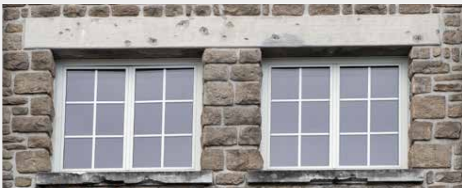
Impacts de balles sur la façade du bâtiment principal.
