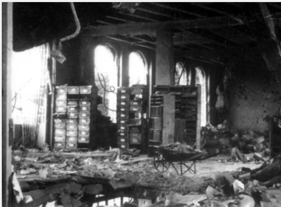
L'intérieur du bâtiment principal dévasté.
